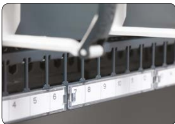
16. Patchpanelet er som standard mærket 1-24, men det kan ændres.
